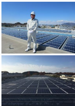
太陽光パネル
